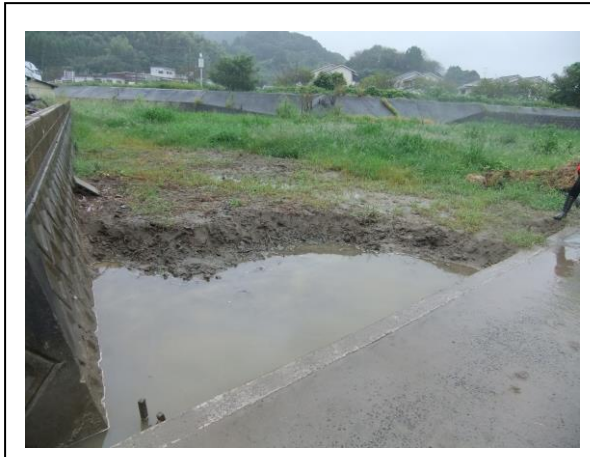
(作業現場：田圃一面土砂で埋まっています)
