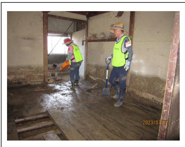
(5)広川町太田地区、被災家屋倉庫から災害ゴミを搬出
