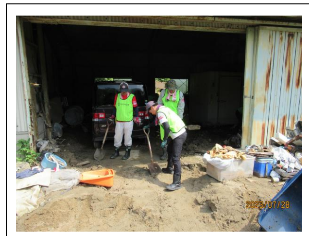
(5)28日 倉庫前の土砂
